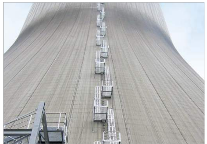
Steigleiteranlage an einem Kühlturm
