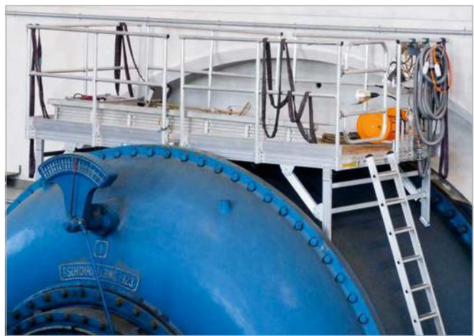
Fest montierte, umlaufende Absturzsicherung
