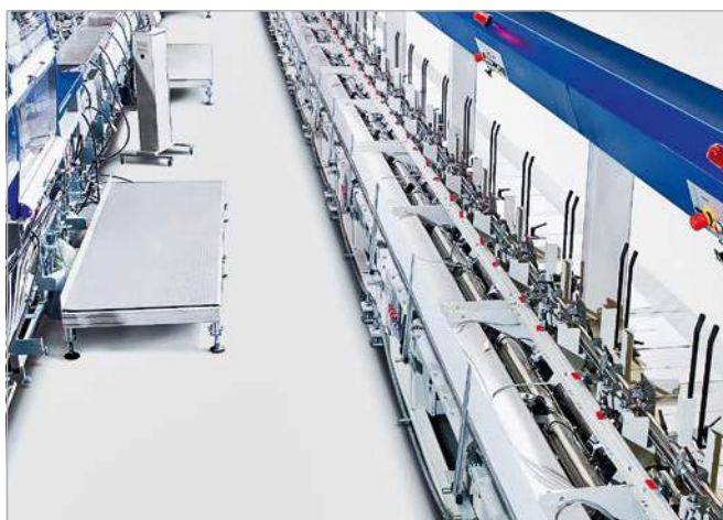
Arbeitsbühne mit höhenverstellbaren Maschinenfüßen zur Bedienung der Anlage
